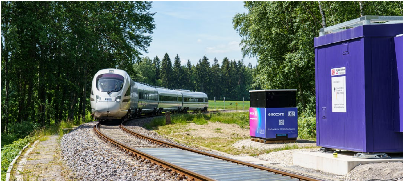
Abb. 3: Encore Batteriespeichersystem am Digitalen Testfeld in Scheibenberg
